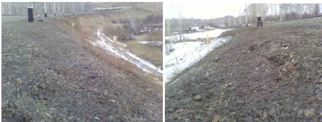
Рис.3.1 Просадка грунта, видимая на дневной поверхности.
